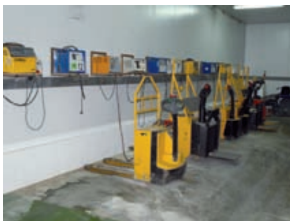
Zona de carga de baterías.
